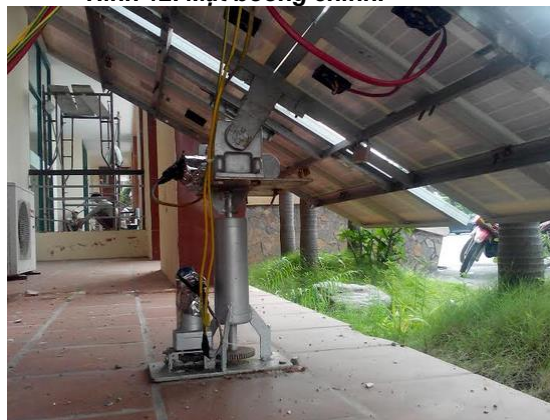
Hình 14. Điều chỉnh góc tấm pin.
